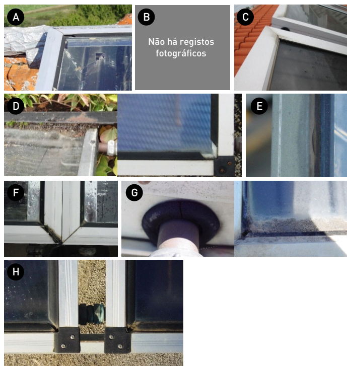
Fig. 3 - Registos da degradação observada nos componentes elastoméricos (vedantes, juntas e passa-tubos).
